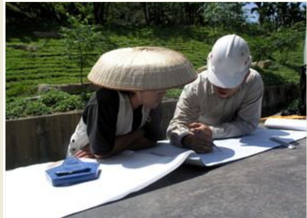
現場で詳細打合をする新故郷小毛(左)と施工会社宋奇易さん
